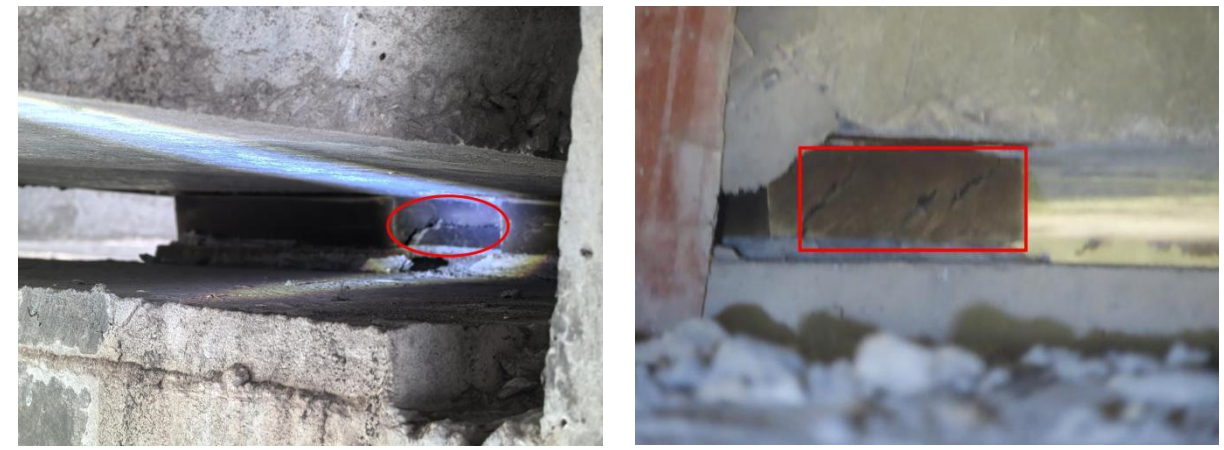
图 5-2 支座体发生剪切变形
