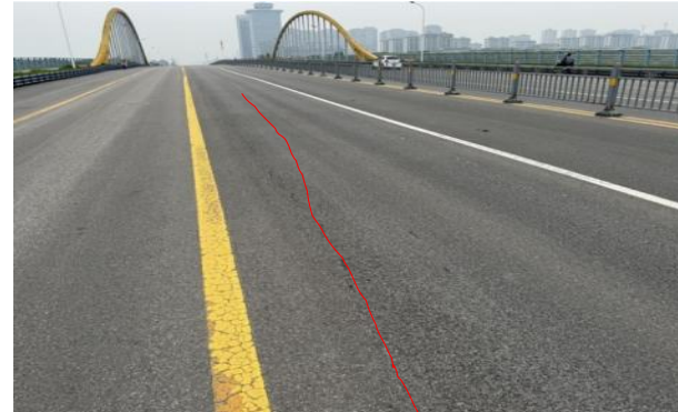
b) 桥面铺装存在半贯通纵缝病害
