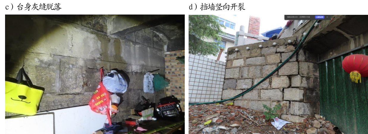
图 4-8 望淮桥下部结构典型病害照片
