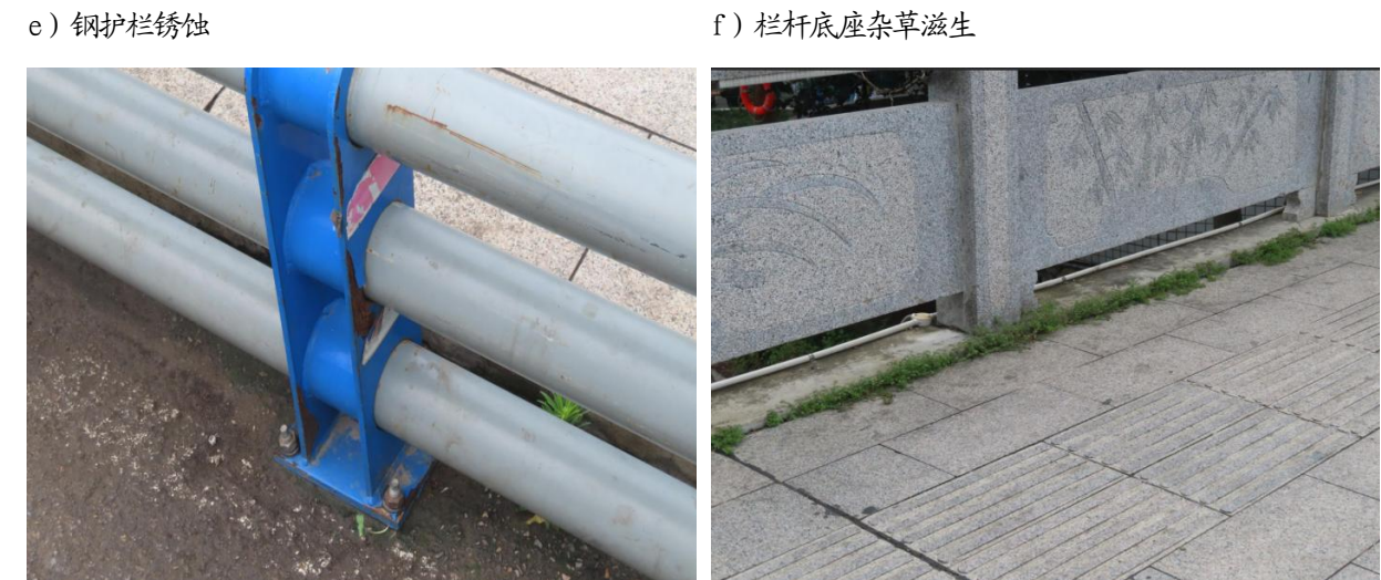
图 4-9 望淮桥桥面系及附属典型病害照片
