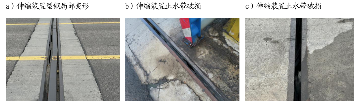
图 5-6 汴河大桥伸缩装置病害照片
