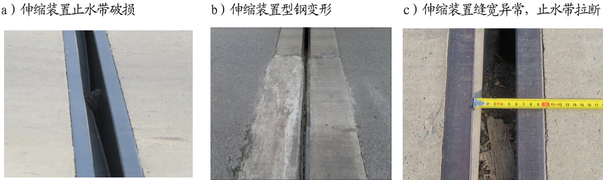
图 5-7 东三环上跨立交桥伸缩装置病害照片
