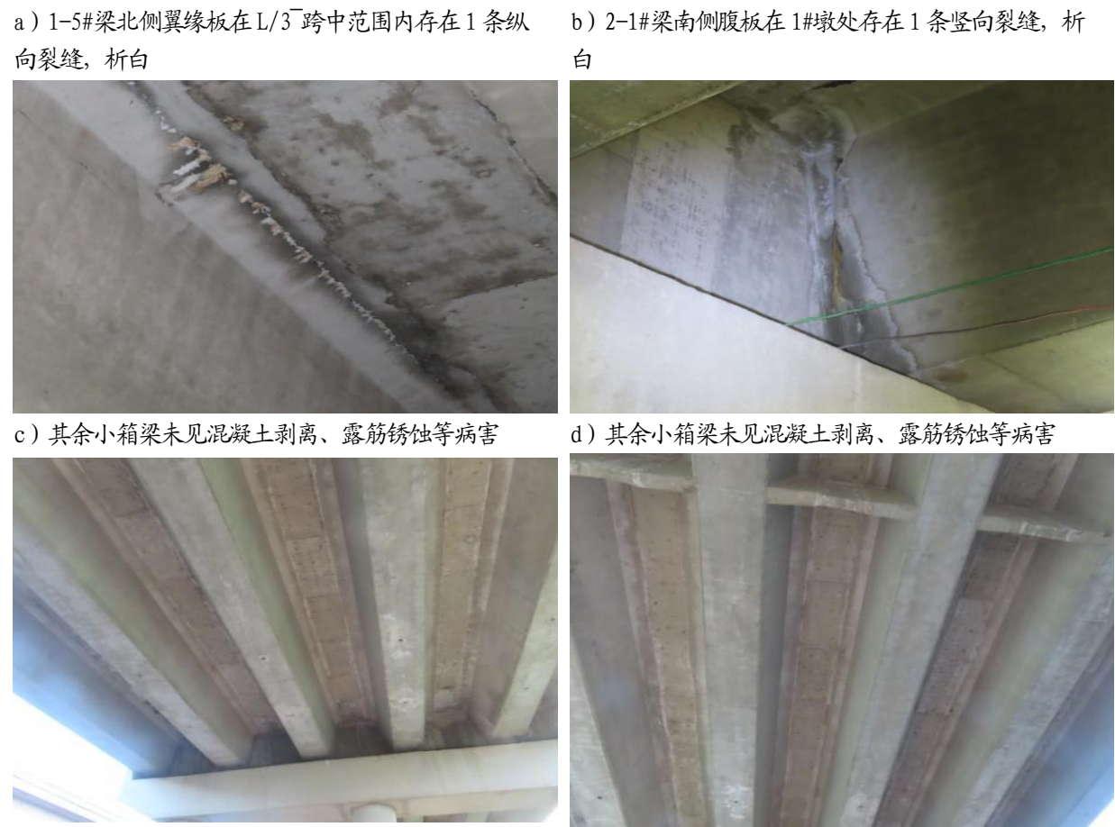
图 4-13 东三环上跨立交桥上部结构病害现场照片
