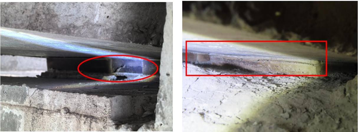
图 4-19 支座病害现场照片
