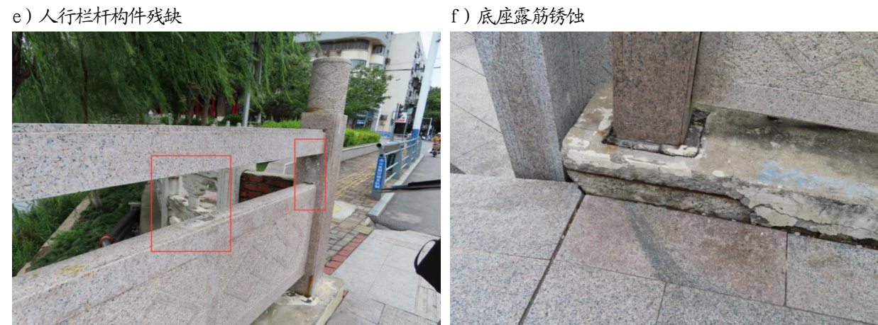
图 4-6 拱辰桥桥面系及附属典型病害照片
