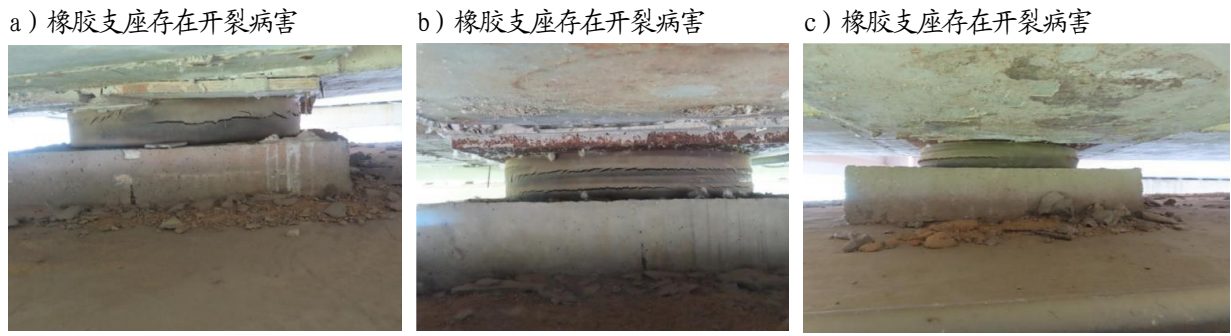
图 5-4 汴河大桥支座病害照片
