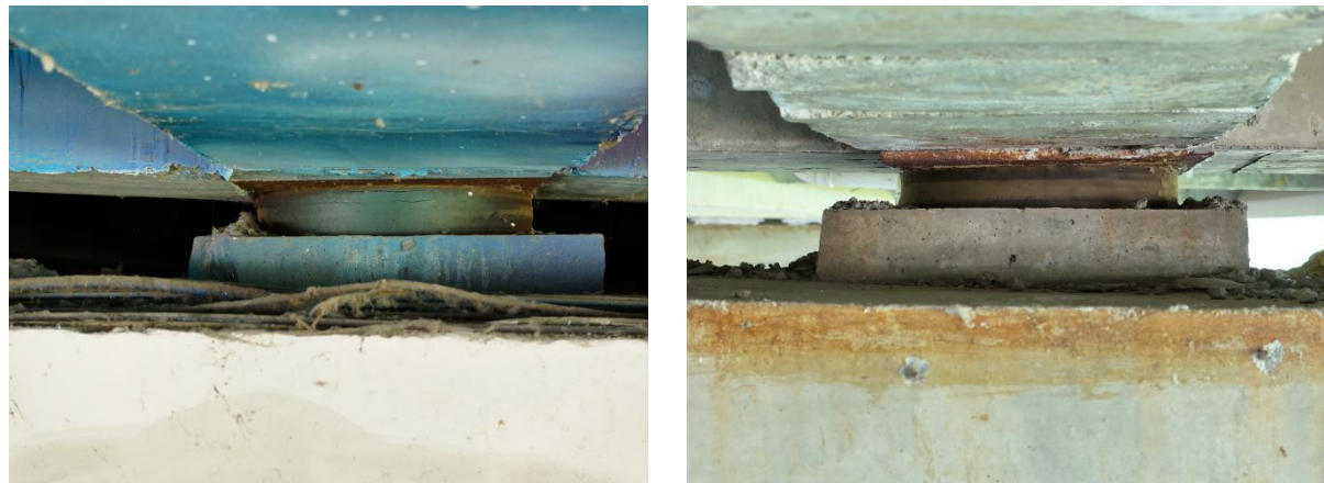
图 4-27 支座变形现场照片
