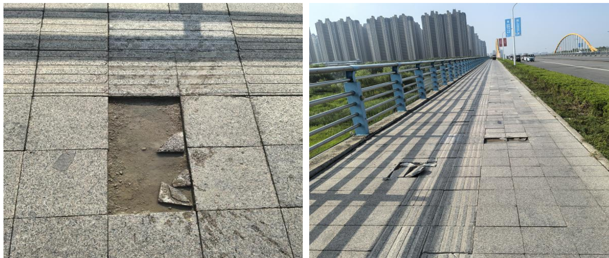
图 4-28 铺装病害现场照片
