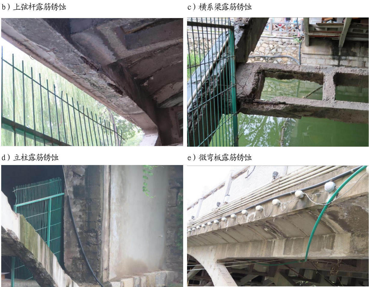
图 4-7 望淮桥上部结构典型病害照片
