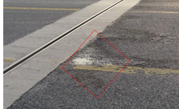
a) 桥面铺装存在坑槽病害
