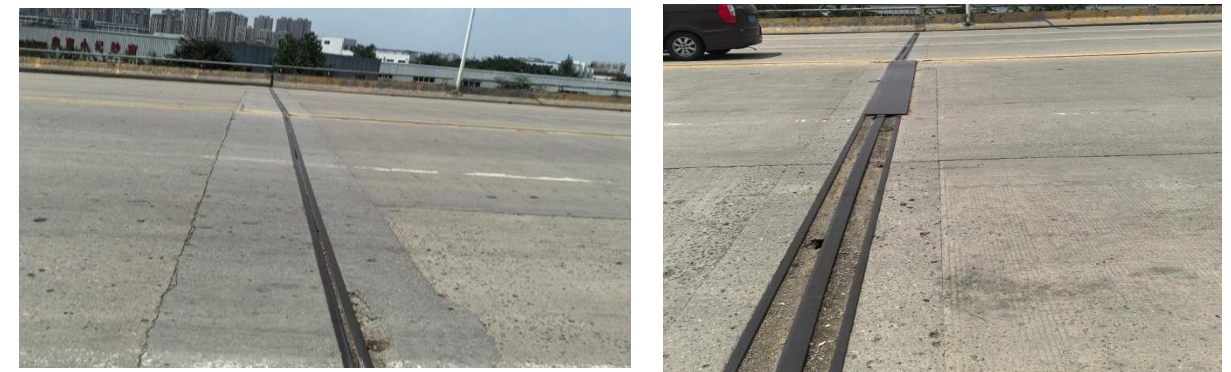
图 4-18 伸缩装置病害现场照片
