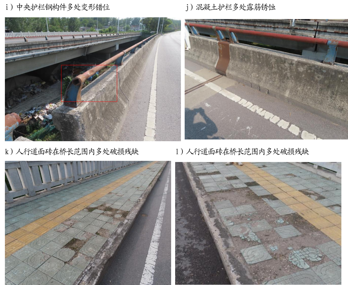
图 4-15 东三环上跨立交桥桥面系及附属结构病害现场照片
