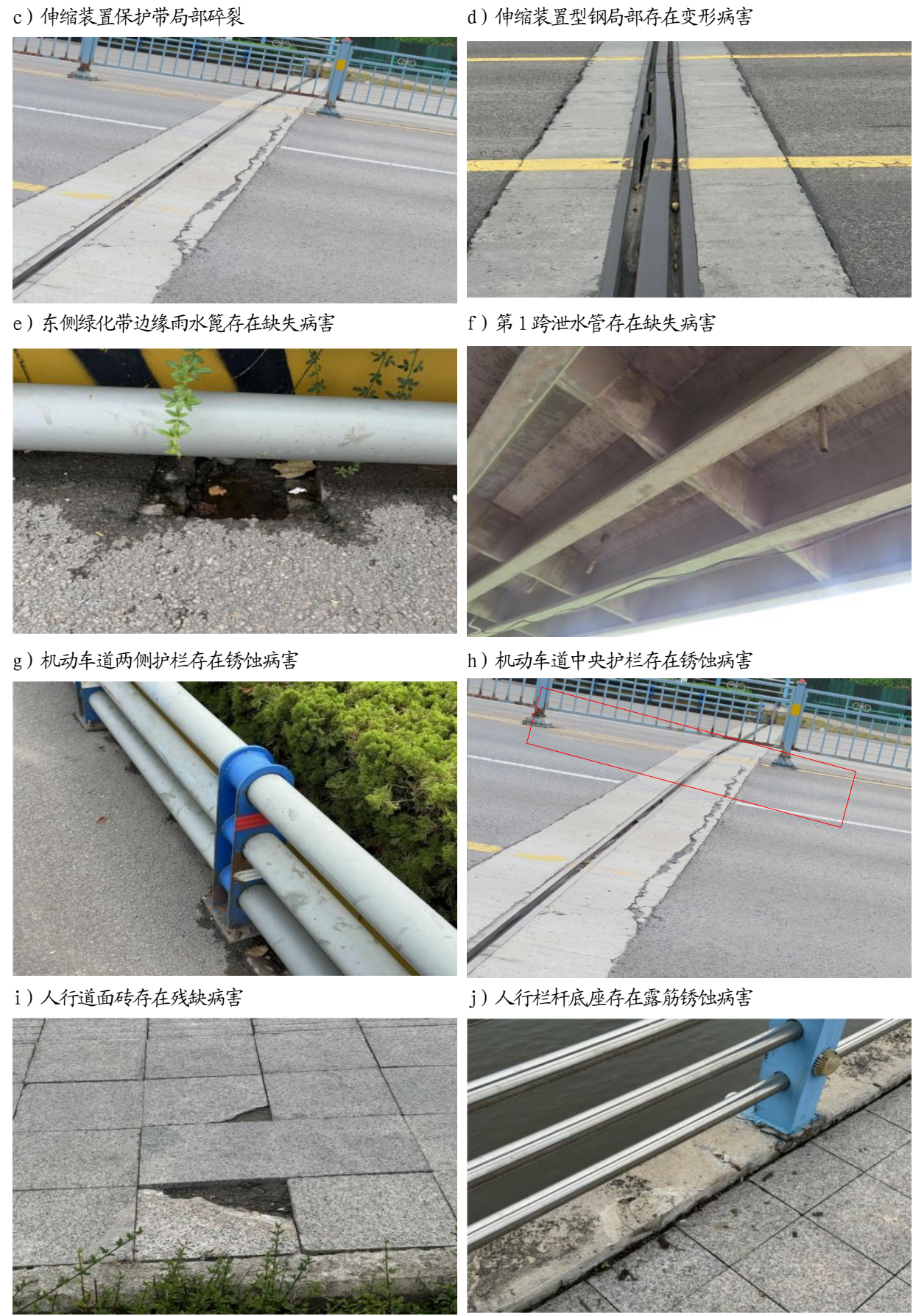
图 4-12 汴河大桥桥面系及附属结构病害现场照片
